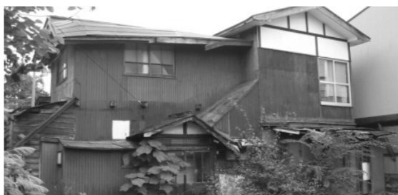
町内の半壊状態にある空き家
